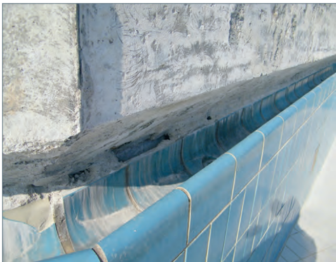
■ Fliesenabbruch oberhalb des Rinnenformsteins
