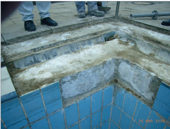
■ Abbrucharbeiten am Beckenkopf; Fotos (ohne weitere Quellenangabe): Karl-Heinz Reuter, Planungsgruppe Bad, Neuss
