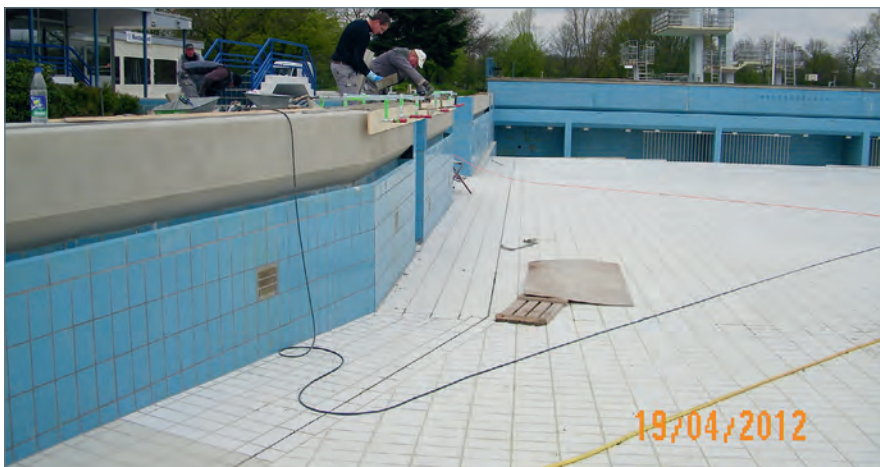
■ Verputzt der früheren Fliesenbelagsfläche
