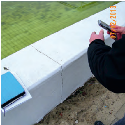
■ Fugenriss in der GFK-Bekleidung des Beckenkopfes ...
